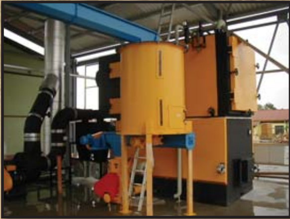
The boiler-room systems Heizräume СИСТЕМЫ КОТЕЛЬНЫХ
